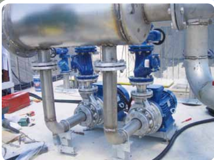
Foto 3 box 8 Pompe di rilancio del percolato estratto.
