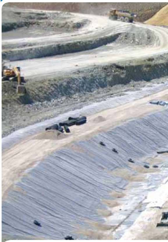
Foto 2 box 8 Vasca di raccolta del percolato dove sono allocate le pompe di estrazione del percolato.
