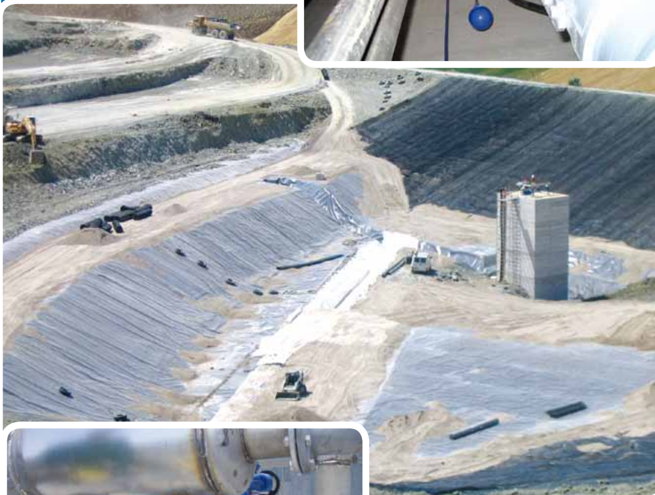
Foto 2 box 8 Vasca di raccolta del percolato dove sono allocate le pompe di estrazione del percolato.
