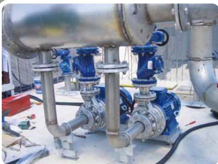
Foto 3 box 8 Pompe di rilancio del percolato estratto.
