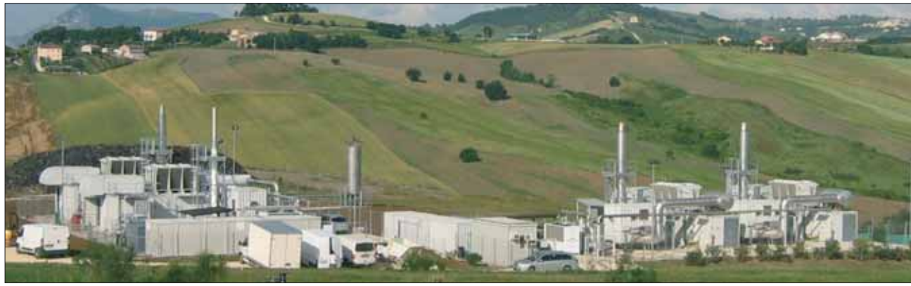
La nuova centrale bioelettrica gestita dalla So.Ge.Nu.S.
